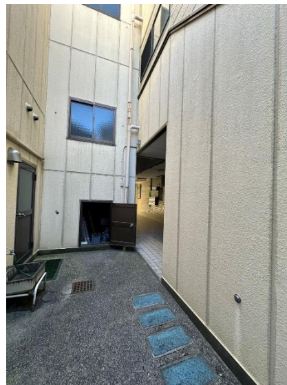
建物裏 水道メーターボックス
